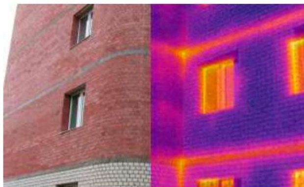
Рисунок 5 – Теплопотеря через окна на тепловизоре
